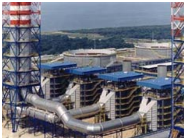
Impianto policombustibile di Montalto di Castro
