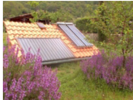
Un tetto con pannelli solari e cespugli di salvia
