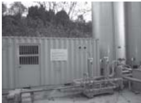
Pozzo e depuratore ad Acqua Palomba
