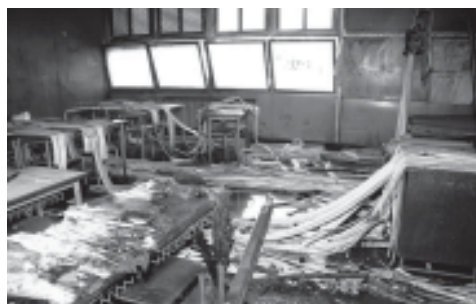
Un'aula del 'Socrate' dopo l'incendio
